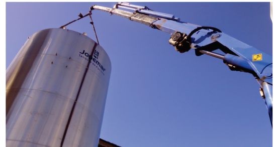
TANQUE: possui capacidade para 50 mil litros
